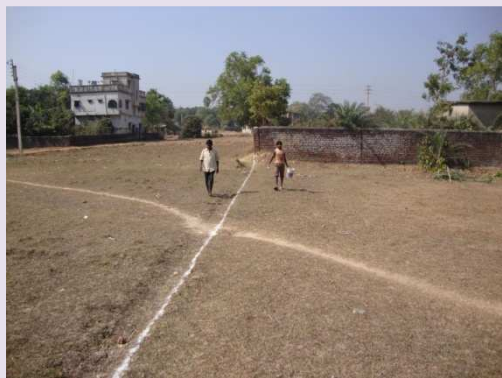
Im Januar läutet Nico Golembiewski den Baubeginn ein: die Grundstücksgrenze wird markiert
